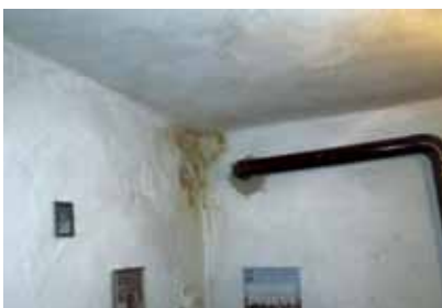
Noch ist das Dach undicht.
